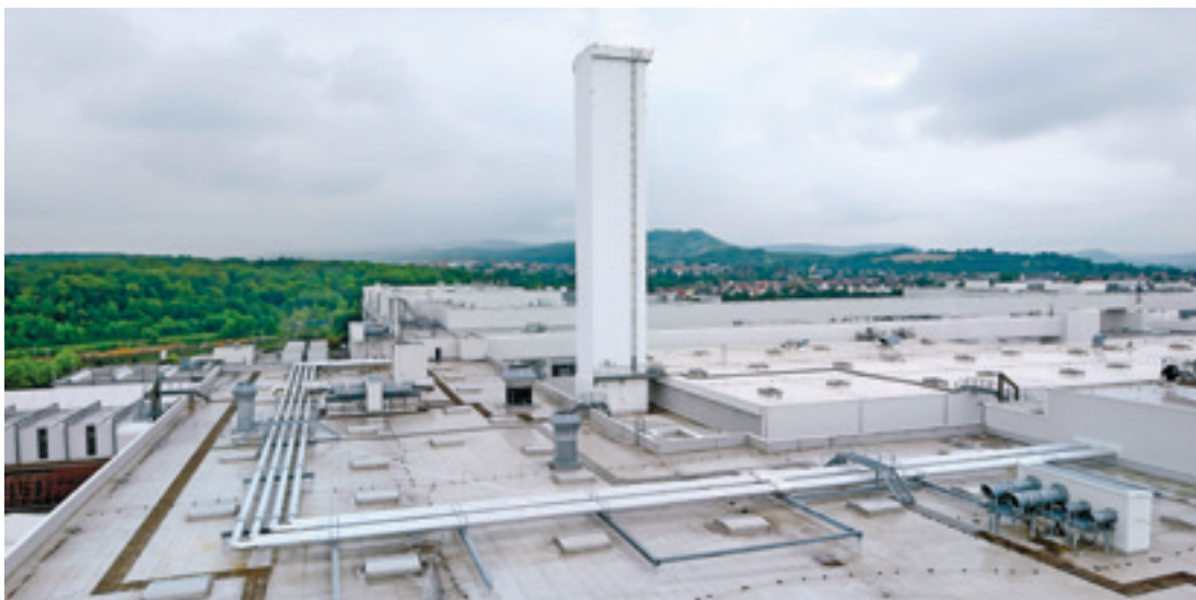
Trassenverlauf auf der Lackiererei
