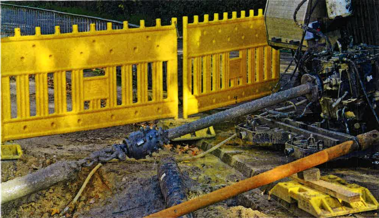
Das Verlegen von Fernwärmeleitungen mit dem Horizontal-Spülbohrverfahren schont die Umwelt Quelle: Brugg Rohrsysteme
