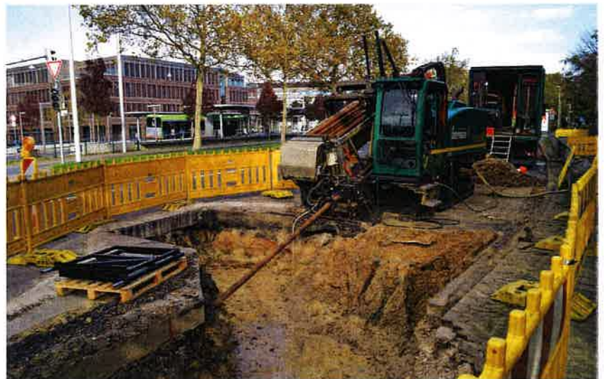
Bild 2. Von der ersten Baugrube aus wurde mit dem Bohrgerät die entsprechenden Bohrungen vorgenommen Quelle: Brugg Rohrsysteme
