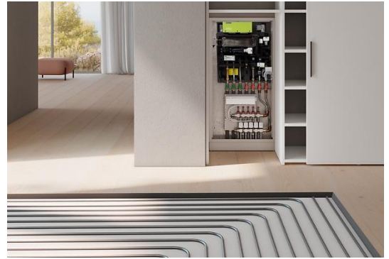
Die Wohnungsstation steht mit statischem oder gemischten Heizkreis zur Verfügung und bietet so maximale Flexibilität. © KERMI
