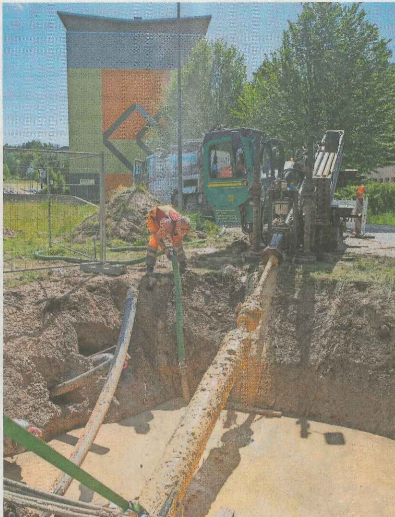
Mittels Spülbohrverfahren werden hier am Eichicht die neuen Erdkabel verlegt. Der Vorteil daran: Die Kreuzung an Baumarkt und Wohngebiet muss nicht aufgegraben werden.
