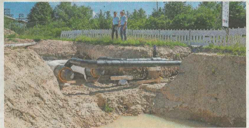
Nahes des Autohauses an der Büchelohrer Straße sind die neuen Leitungen bereits verlegt. Weil der Bedarf an Fernwärme im Wohngebiet am Eichicht nicht so groß ist, wird ab hier mit kleineren Kabeln weitergearbeitet.
